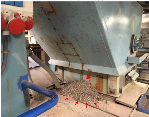
Figur 4: Askelekkasje ved slaggutmater linje 2.
