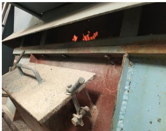
Figur 6: Hull i slaggutmateren, linje 1.
